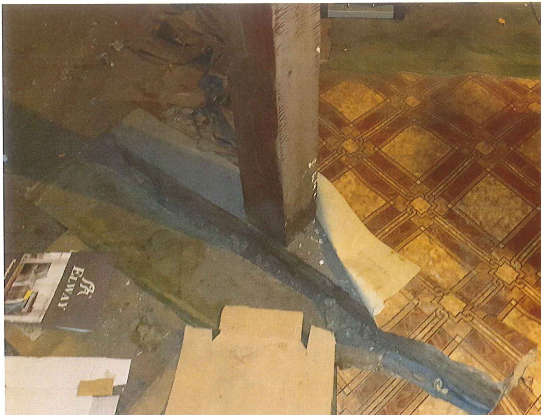
Zdj. nr 4. Widoczne zacieki na podłodze przy podwalinę..
