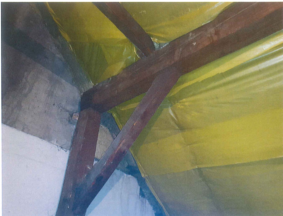
Zdj. nr 2. Widoczne na płatwi ślady po zaciekach wyniku nieszczelności dachu.
