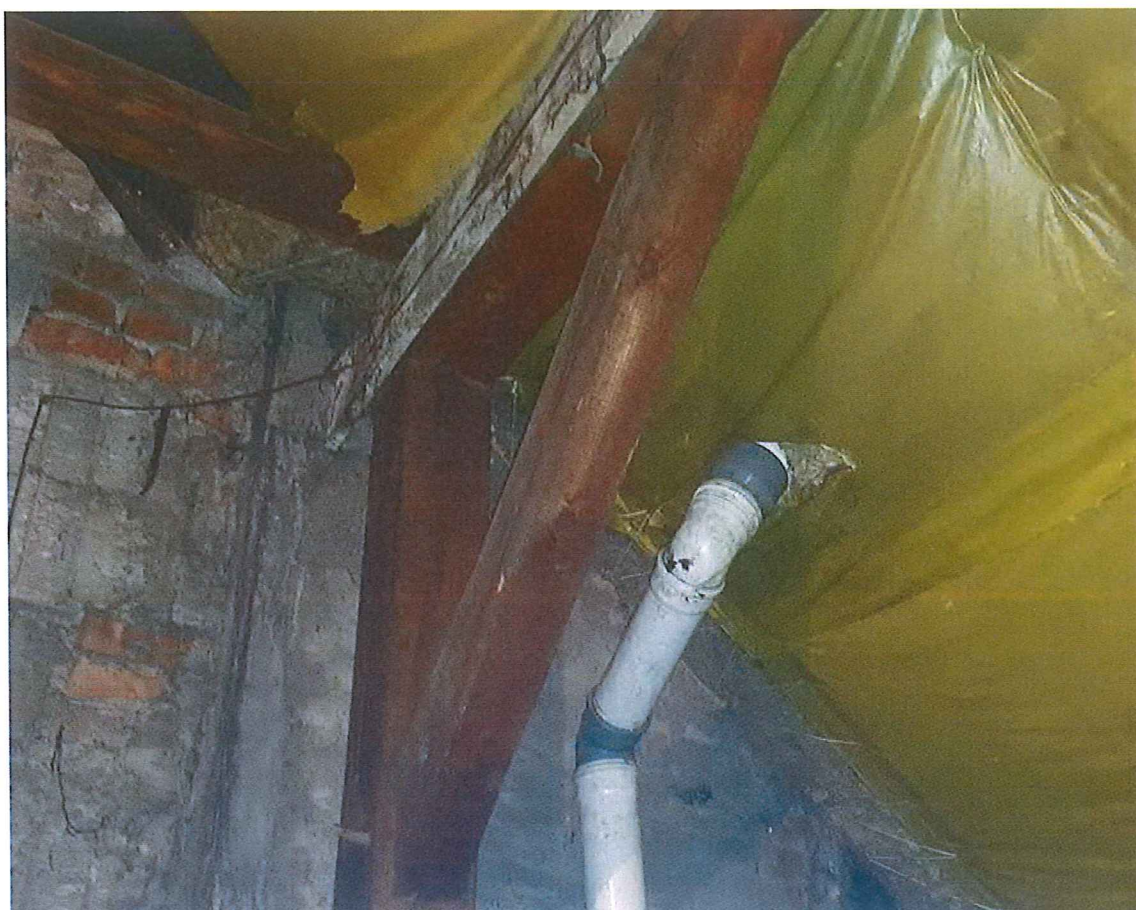
Zdj. nr 1. Widoczne na płatwi ślady po zaciekach wyniku nieszczelności dachu.
