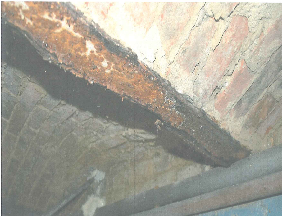
Zdj3. Korozja belki teowej stropu w pom. nr 1.
