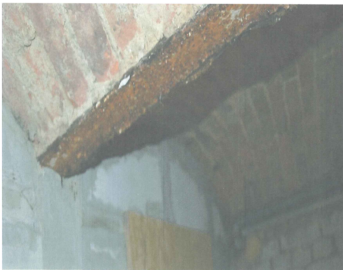
Zdj.4. Korozja belki teowej stropu w pom. nr 1.
