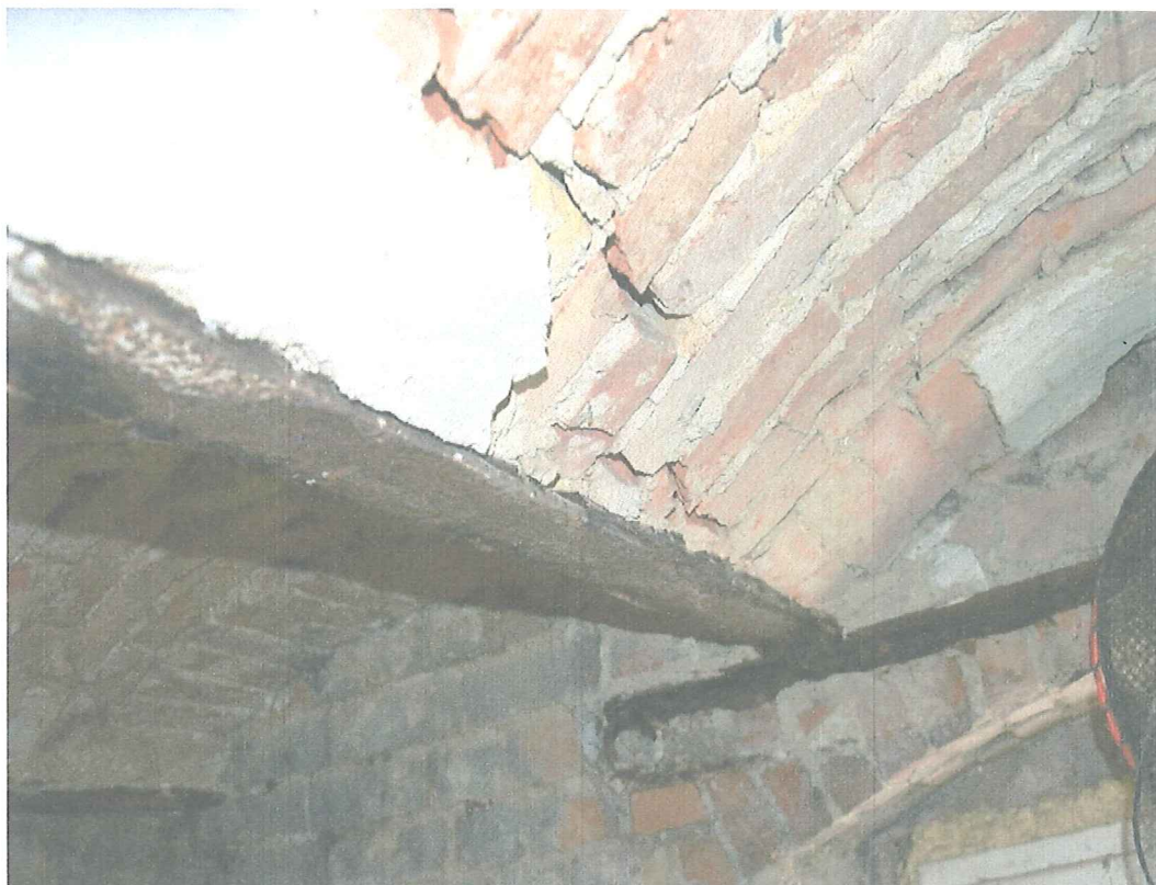
Zdj.9. Korozja belki teowej, spękania sklepienia stropu w pom. nr 3.
