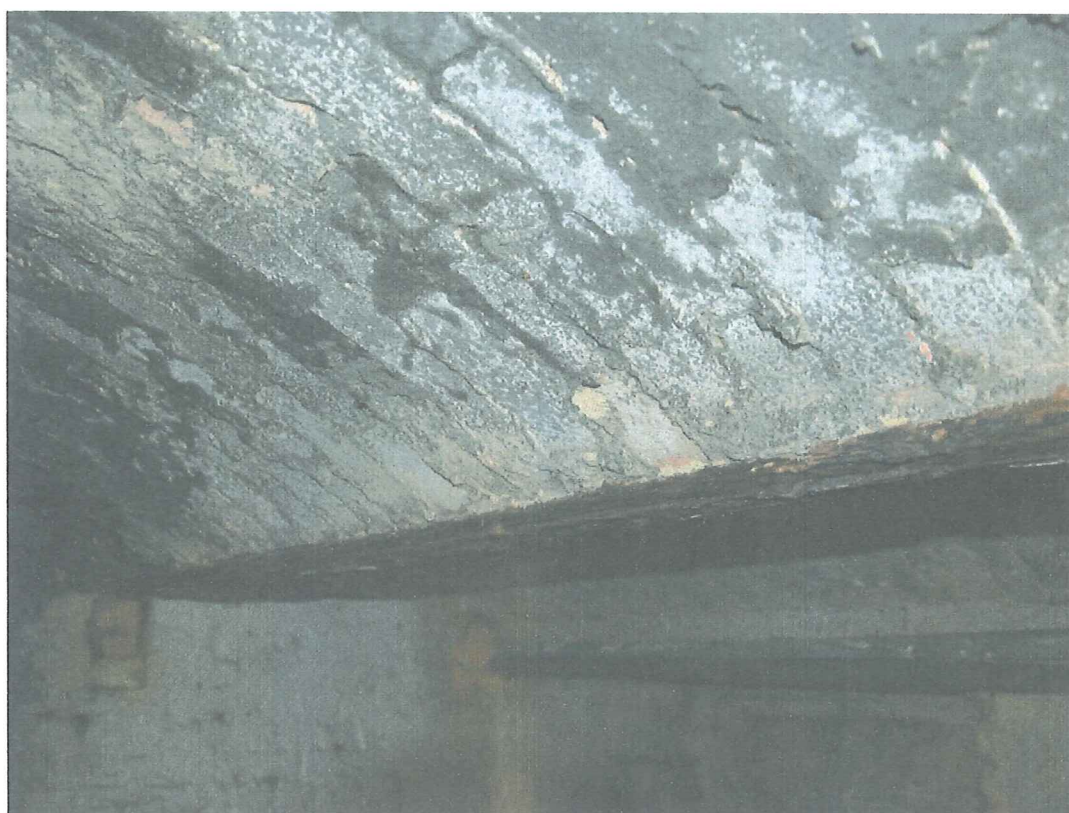
Zdj.10. Korozja belki teowej stropu w pom. nr 4.
