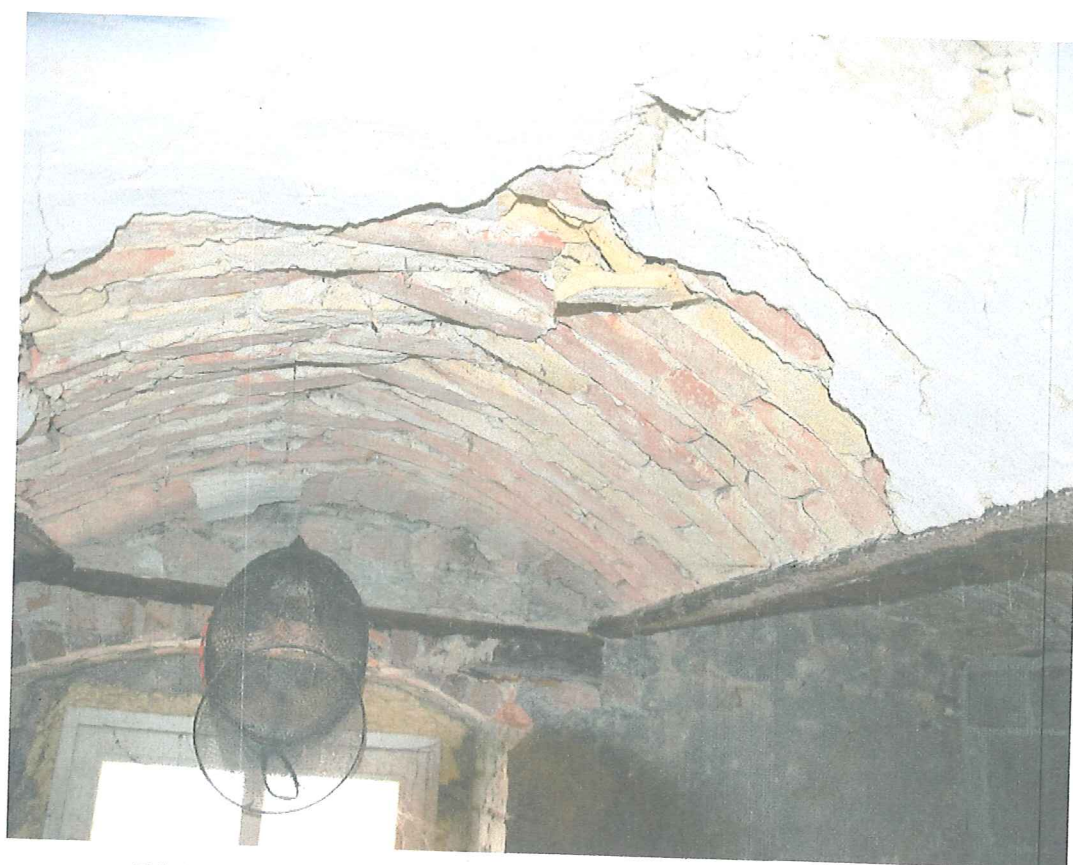
Zdj.8. Korozja belki teowej, spękania sklepienia stropu w pom. nr 3.
