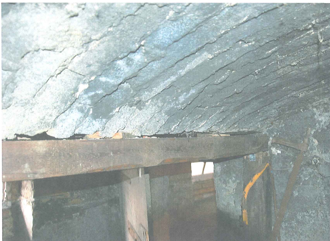
Zdj.12.Podparcie stropu w miejscu braku półki dolnej kształtownika teowego.
