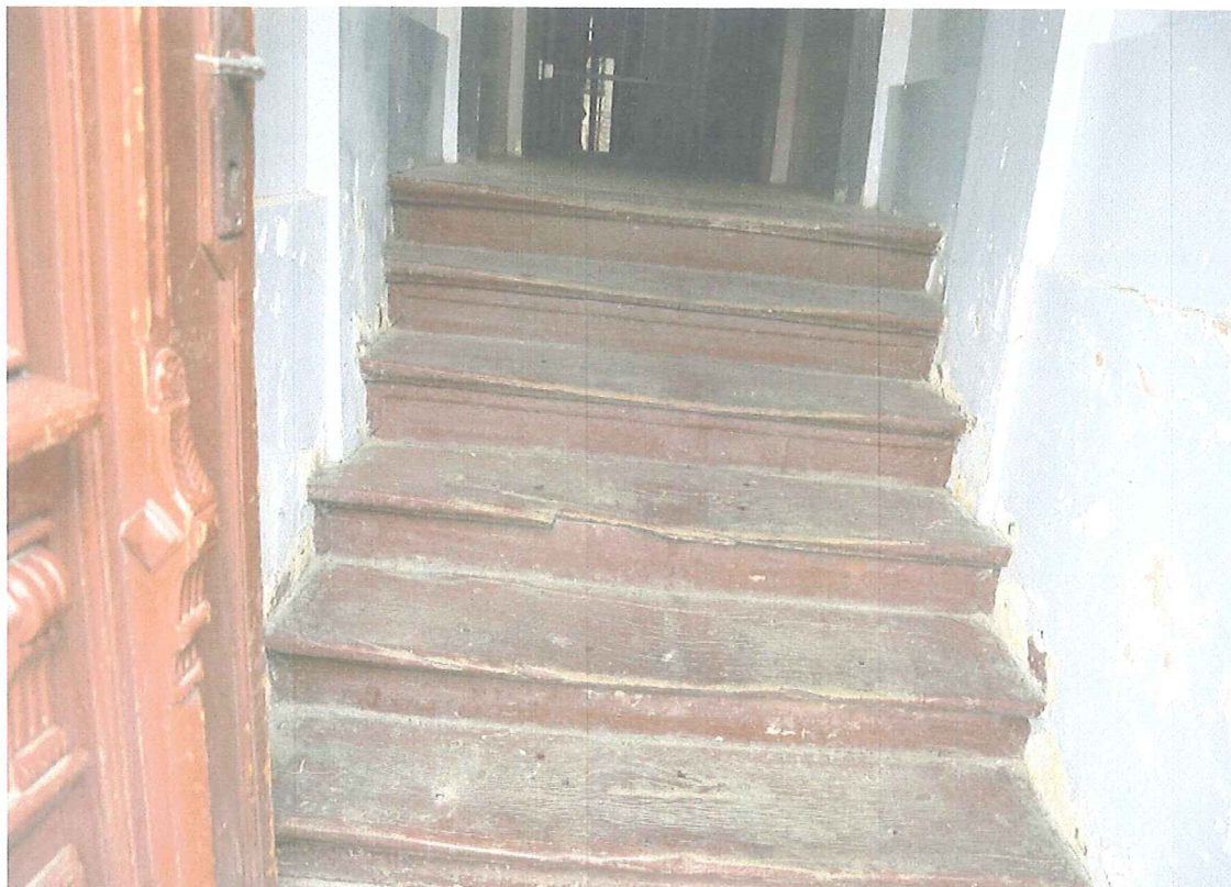
Zdj.18. Wejście od ul. Solankowej, uszkodzone schody, wytarte powłoki malarskie, ubytki struktury tynków.
