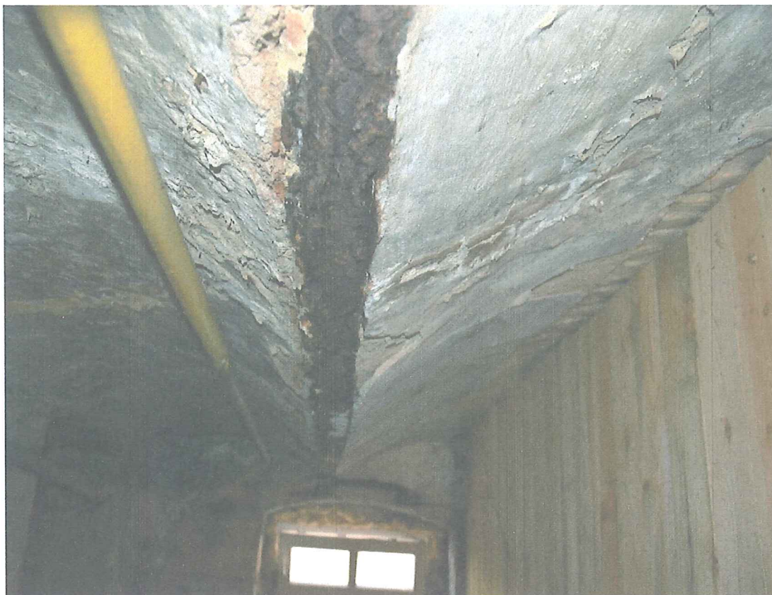
Zdj.13. Korozja belki teowej stropu w pom. nr 5.
