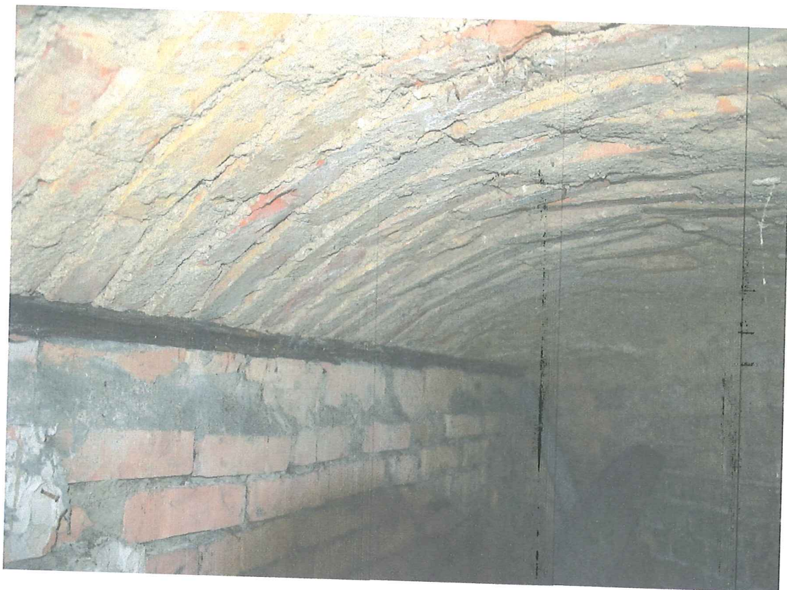
Zdj.7. Korozja belki teowej stropu w pom. nr 2.
