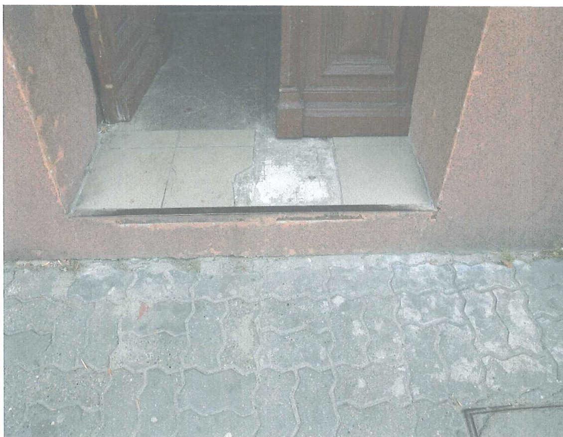
Zdj.20.Brakujące okładziny posadzki przy wejściu do budynku.
