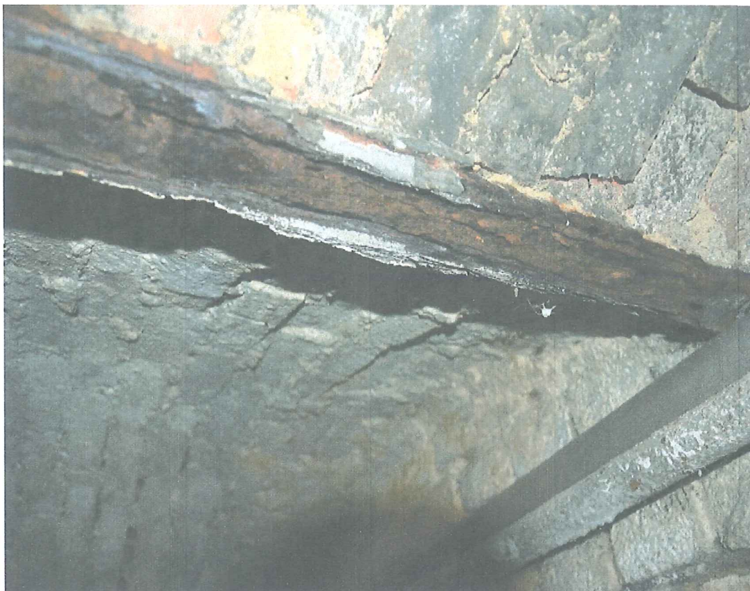
Zdj.11. Korozja belki teowej stropu w pom. nr 4.
