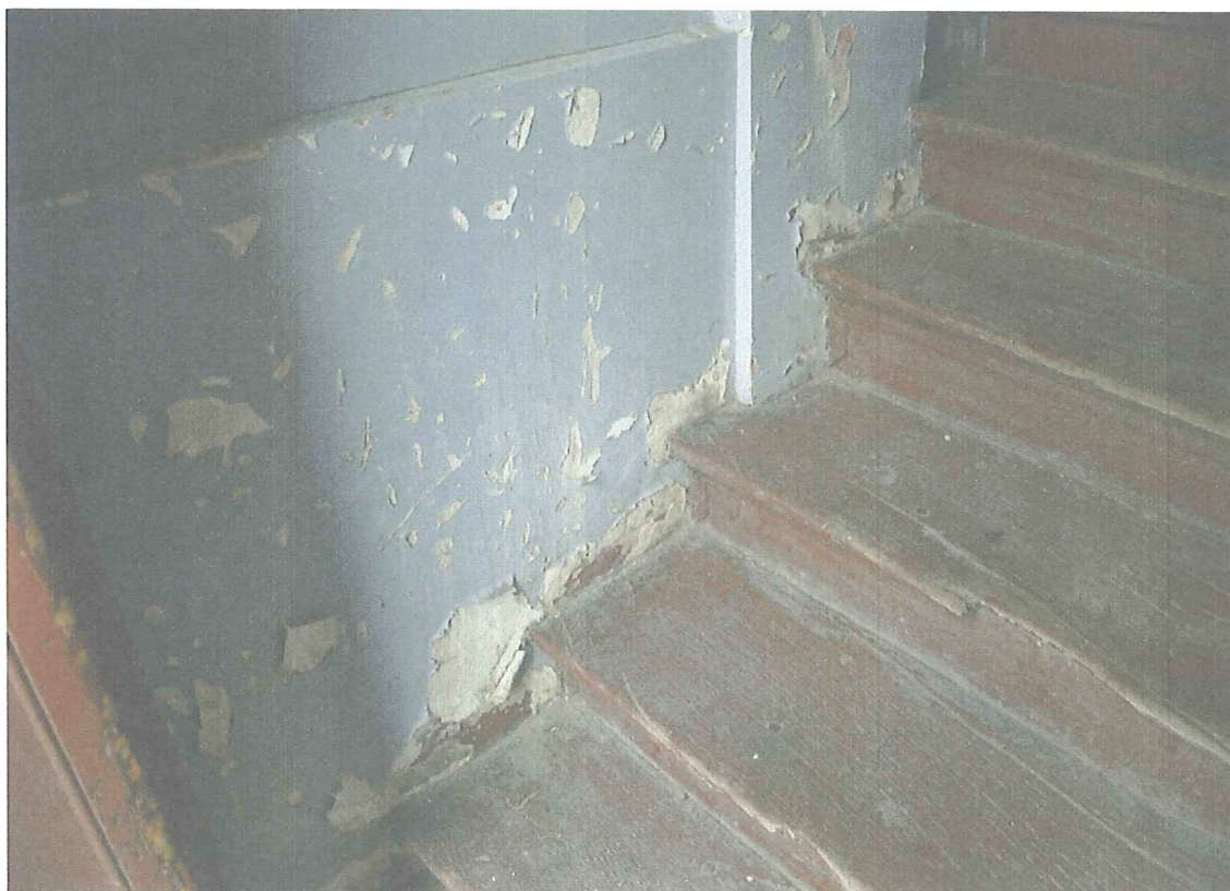
Zdj.19. Wejście od ul. Solankowej, ubytki struktury tynków, powłok malarskich.
