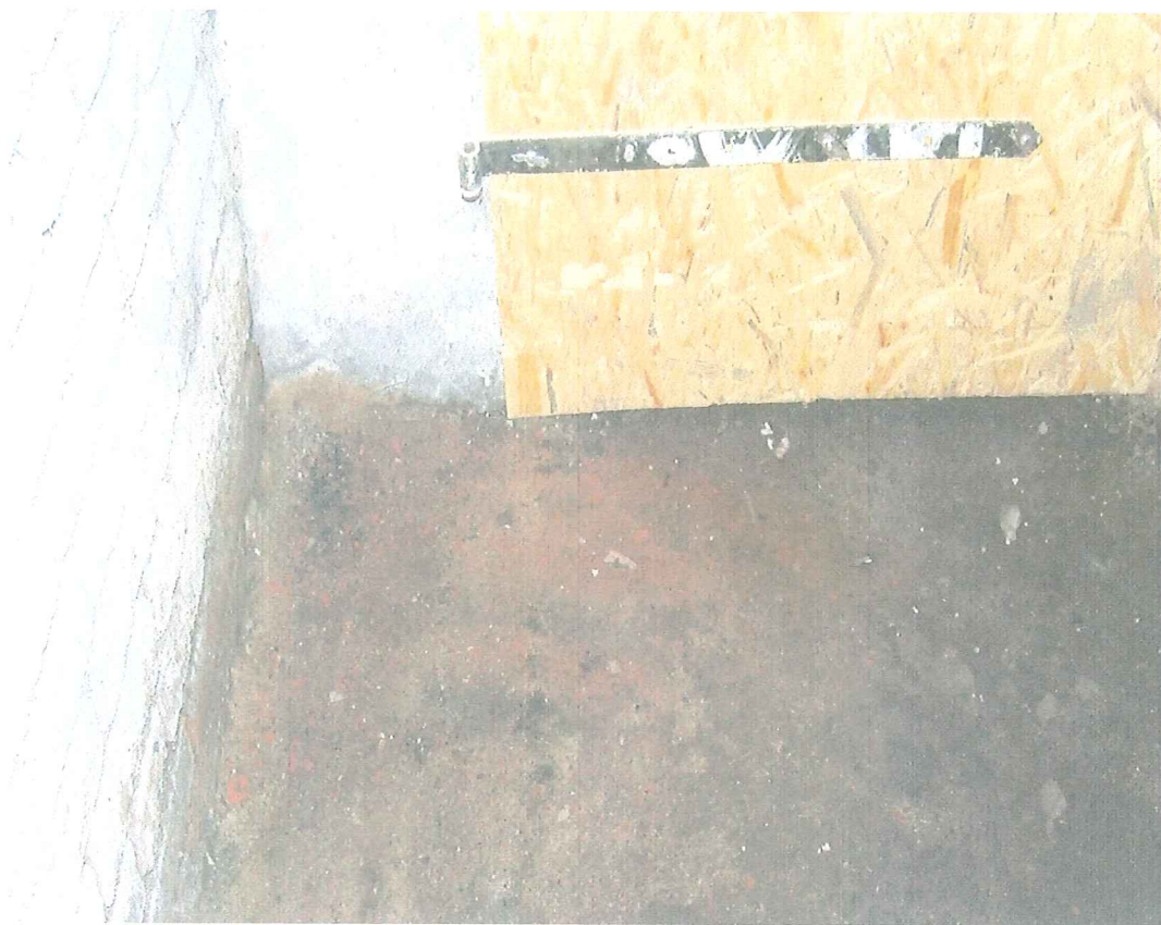
Zdj.14. Widoczne zawilgocenie ścian i posadzki.
