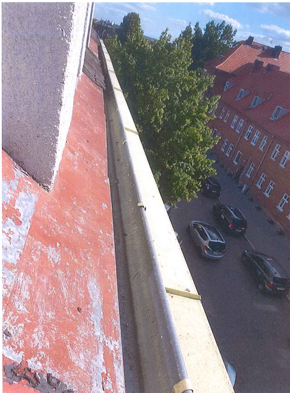
Zdj. nr 10. System odwodnienia dachu - rynny
